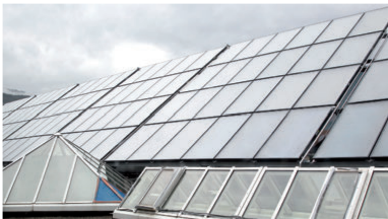
Les panneaux sur le toit de Flottibulle
